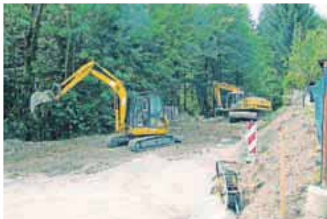
Naj bosta cesti v Vazah in skozi Otoče vzorec, kako je potrebno obnavljati ceste po vsej občini, je dejal predsednik sveta Krajevne skupnosti Brane Fajfar.
